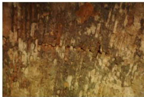
Figura 7: Trinca transversal na abóboda do Trânsito Superior Fonte: Acervo dos autores, 2020
