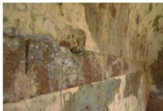
Figura 11: Danos nas proximidades da linha de imposta da abóbada do Corpo da Guarda Fonte: Acervo dos autores, 2020
